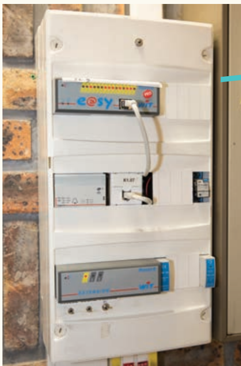
Amélioration du système d'alarme au Foyer Georges-Brassens
